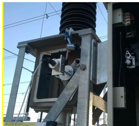
Цифровой вращающийся преобразователь установленный наверху высоковольтного элегазового выключателя ABB LTB 245 кВ
