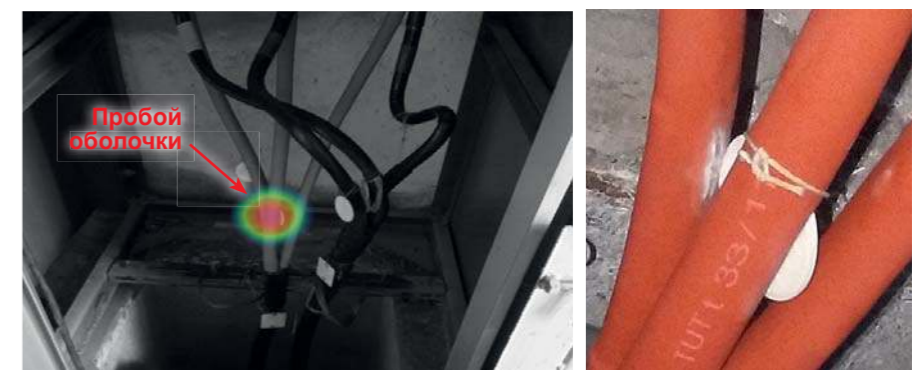
Рис. 7. Дефект оболочки кабеля в РУ 10 кВ
