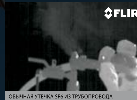
ОБЫЧНАЯ УТЕЧКА SF6 ИЗ ТРУБОПРОВОДА
