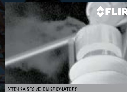
УТЕЧКА SF6 ИЗ ВЫКЛЮЧАТЕЛЯ
