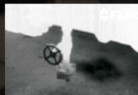
УТЕЧКА МЕТАНА НА ПЛОЩАДКЕ ГПЗ
