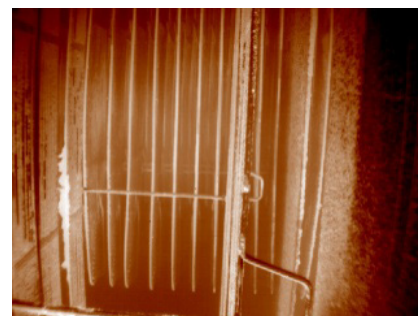
Теплообменник пароперегревателя в котле мощностью 700 МВт, работающем на угле PRB
