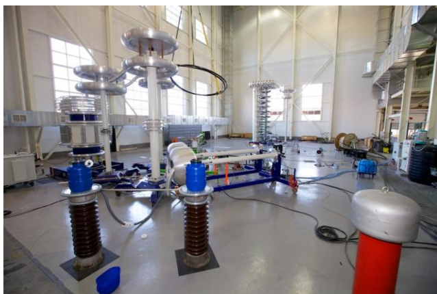
Высоковольтная часть лаборатории
